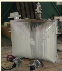
NH高圧進相コンデンサ(当社旧製品)の噴油・破壊事故例 (適切な保護がされておらず、ケース破壊に至った事例)
