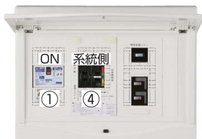
蓄電システム用分電盤
